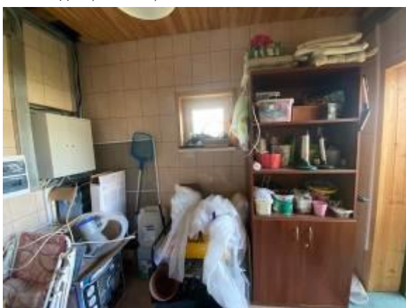
Жилой дом, 1 этаж, котельная ч.п. 3
