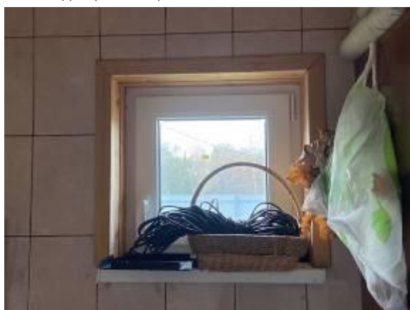
Жилой дом, 1 этаж, котельная ч.п. 3
