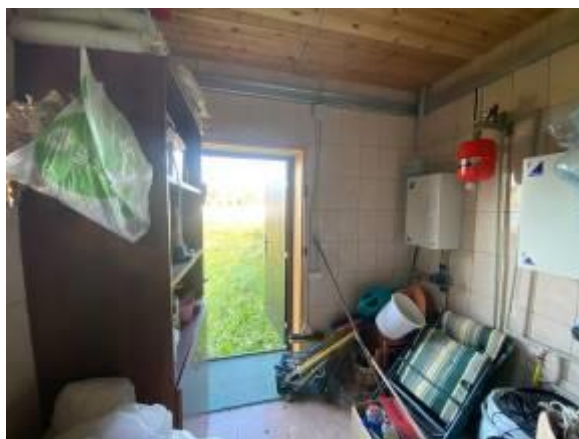
Жилой дом, 1 этаж, котельная ч.п. 3
