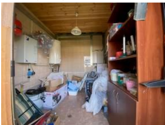
Жилой дом, 1 этаж, котельная ч.п. 3
