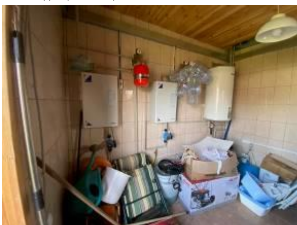
Жилой дом, 1 этаж, котельная ч.п. 3
