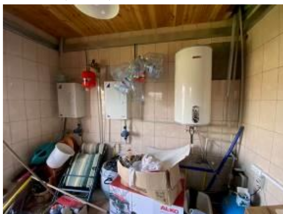
Жилой дом, 1 этаж, котельная ч.п. 3
