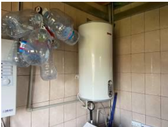
Жилой дом, 1 этаж, котельная ч.п. 3
