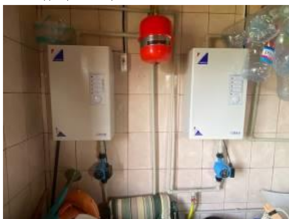
Жилой дом, 1 этаж, котельная ч.п. 3
